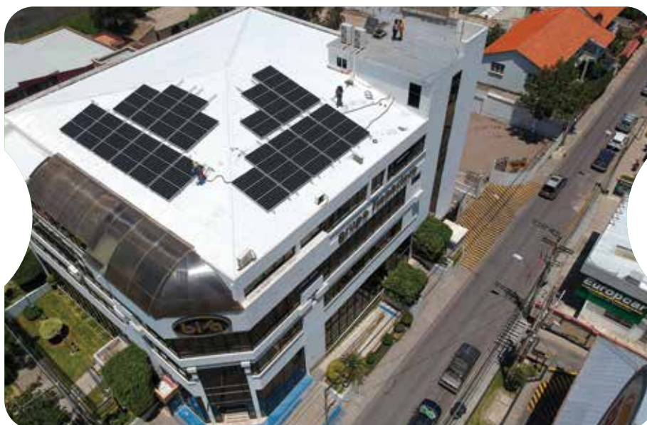
Paneles solares Edificio Principal Cochabamba
