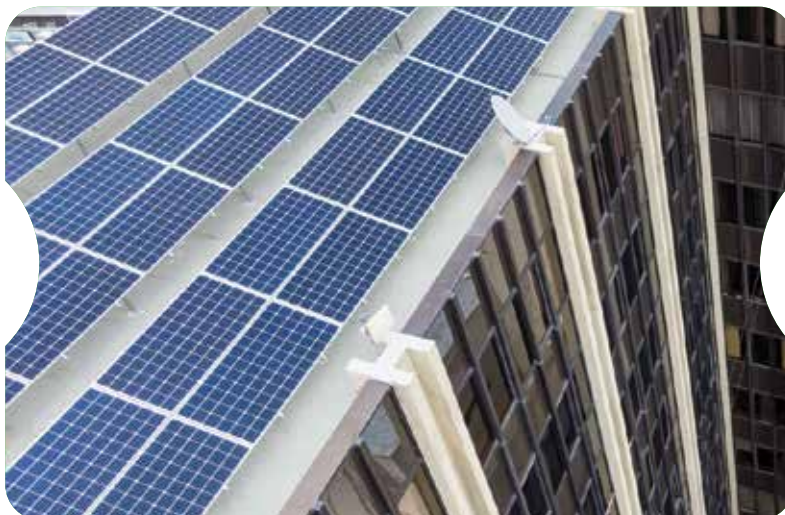
Paneles solares Edificio Nacional
